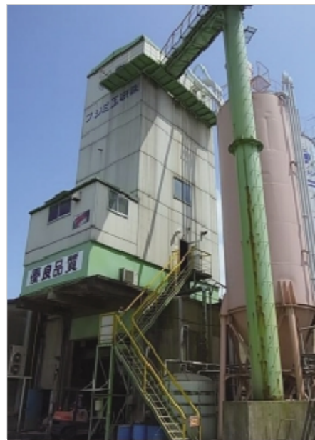
■第2バッチャープラント 練り混ぜ設備 二軸型強制練ミキサー 2.3m 3 1基
