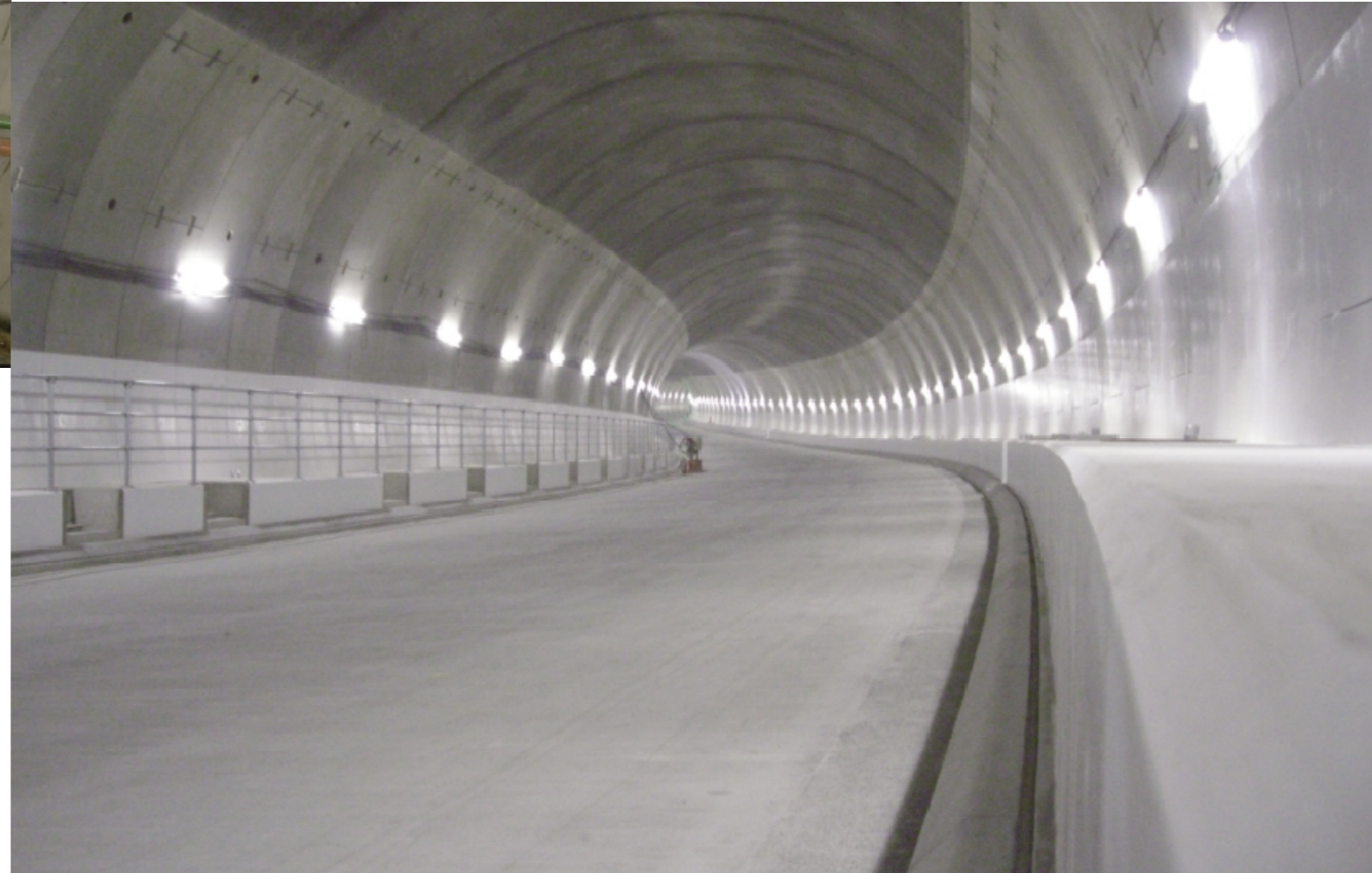
首都高速道路公団 SJ43工区(1-2)トンネル工事 外径：11,900 桁高：400 セグメント幅：1,500 分割数：10
